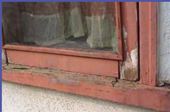
sa nababakbak na pintura
